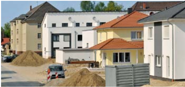
Bauarbeiten auf dem Gelände der Roselies-Kaserne in Braunschweig: Neubau und Erhaltung von Altbestand
