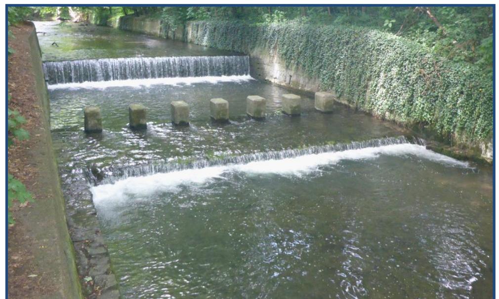
Absturz „Ehem. Brauerei (Wollmarkt)“, Absturzhöhe ca. 1,20 m
